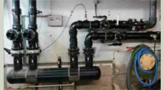
צנרת פקסגול מחוברת לסעפת - פלסאון
